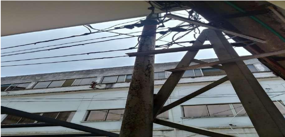
Cableado externo de alta tensión
