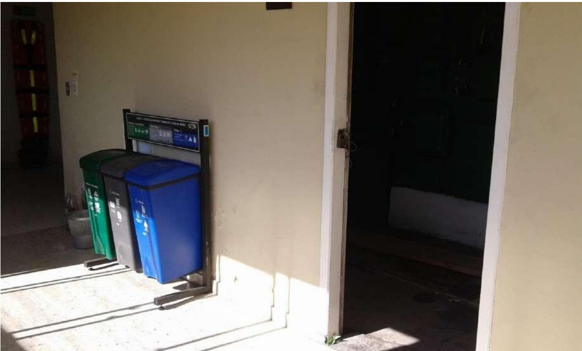
Entrada a zona eléctrica
