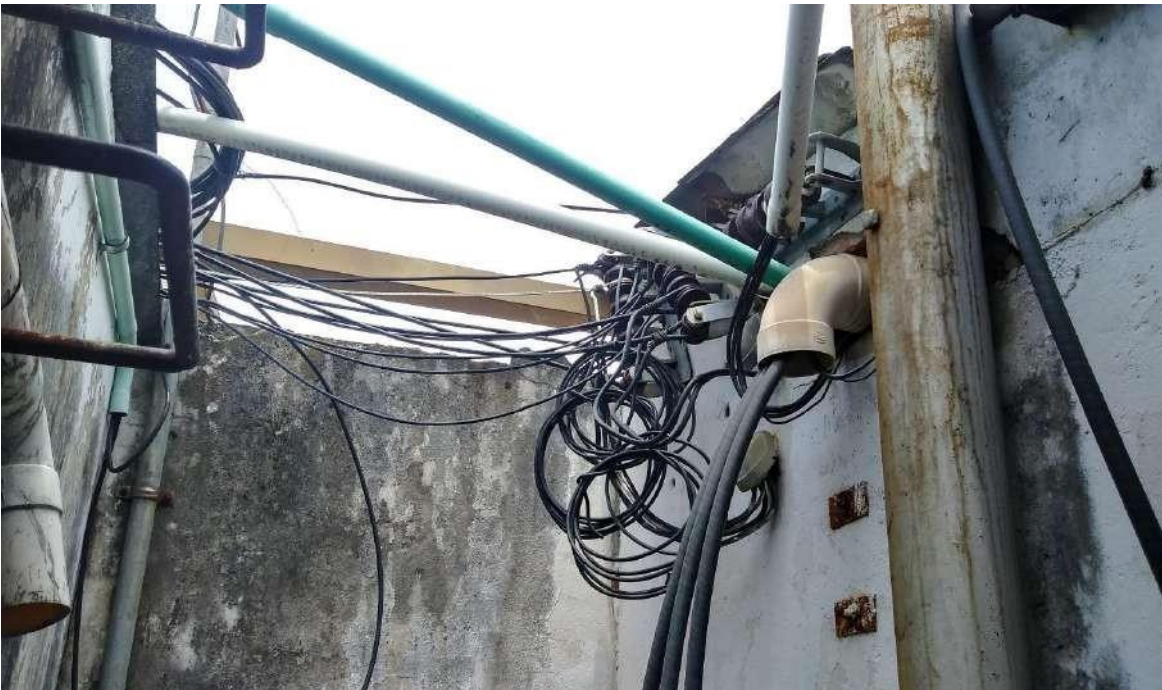
Subestación Eléctrica 3er. Piso
